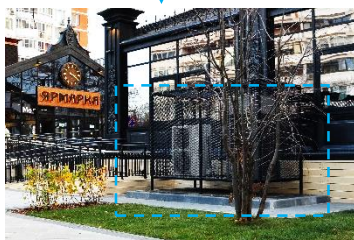
ПЛОЩАДКА КОНДЕНСАТОРНЫХ БЛОКОВ 3 М X 2 М
