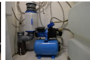
НАСОС ДЛЯ ПОДАЧИ ВОДЫ В РАКОВИНЫ И УНИТАЗЫ
