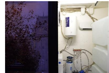
ТЕХНИЧЕСКАЯ ЗОНА ТУАЛЕТНОГО МОДУЛЯ С ЕМКОСТЬЮ ДЛЯ ВОДЫ (1,1 КУБ.М. И САНТЕХНИЧЕСКИМ ОБОРУДОВАНИЕМ
